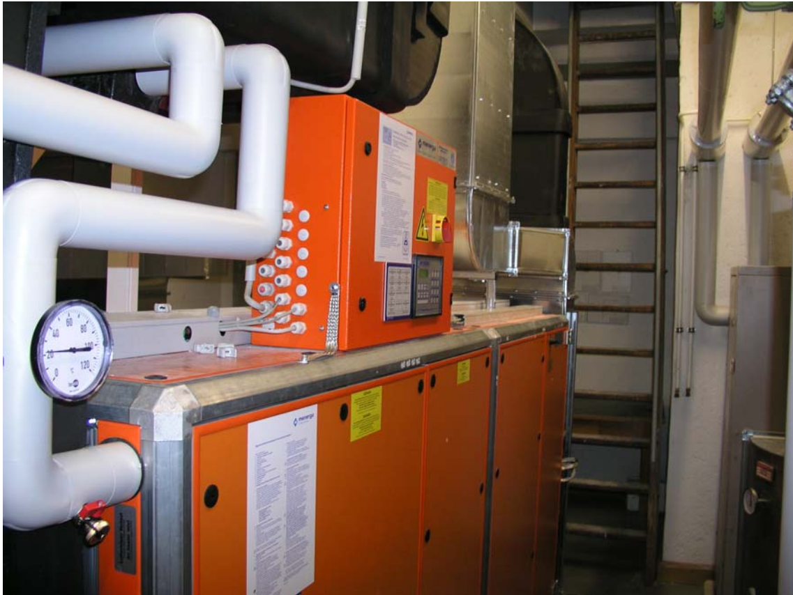
Wärmetauschereinheit mit Bedienfeld und den Zu- und Ableitungen (Gewicht ca. 1 Tonne)
